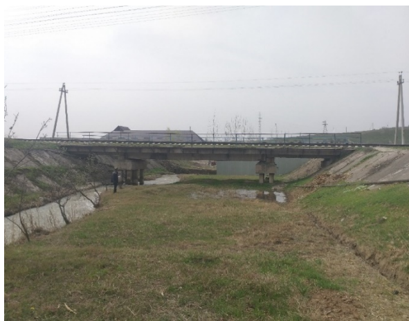
Фото 1. Неравномерное распределение водного потока. Мост на ПК 335+070
