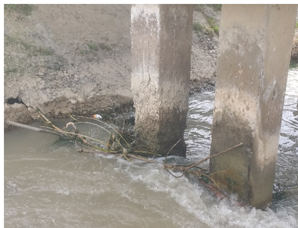
Фото 2. Коррозия бетона и арматуры в сваях. Мост на ПК 335+070
