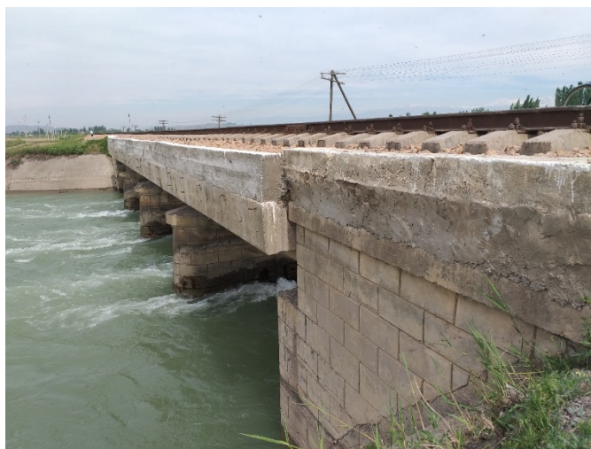
Фото 9. Недопустимое наращивание борта балластной призмы. Мост на ПК 362+129
