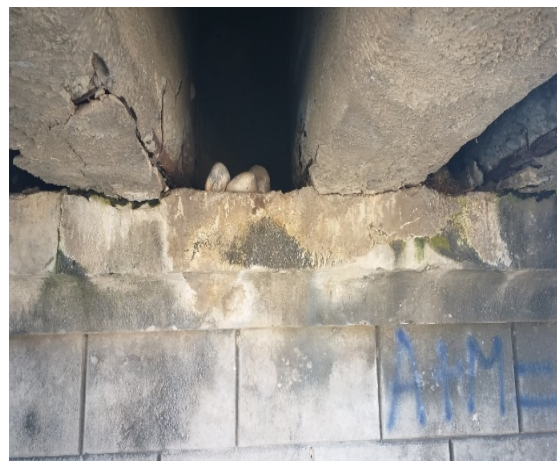
Фото 6. Разрушение приопорных участков главных балок моста на ПК 388+310
