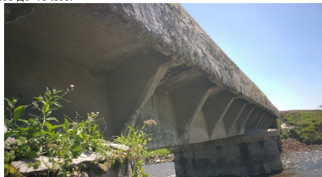
Фото 8. Разрушение борта балластной призмы пролетного строения, отсутствие балок моста на ПК 388+310
