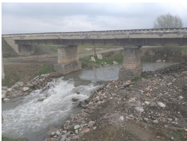
Фото 3. Общий вид моста на ПК 344+005. Размыв русла реки
