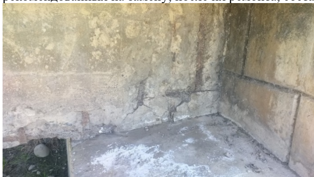
Фото 7. Разрушение приопорных участков балки деформационного шва. Мост на ПК 388+701
