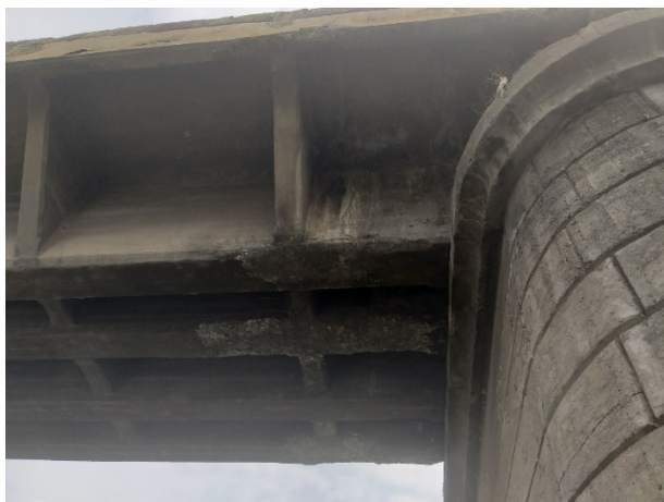
Фото 5. Коррозия бетона и арматуры в пролетных строениях
